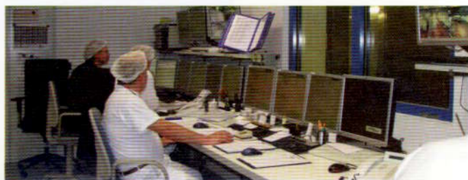
Die Steuerzentrale – beim Anfahren noch mit mehr als normal zwei Bedienern besetzt – wurde an die Schnittstelle der bisherigen und der neuen Käsereilinie versetzt (Foto: DMW)
