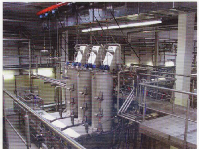
Eine dreisäulige Casomatic MC übernimmt wie schon in der bisherigen Käseherstellung bei der Molkerei Ammerland auch in der neuen Linie das Entmolken und Formenbefüllen (Foto: DMW)
